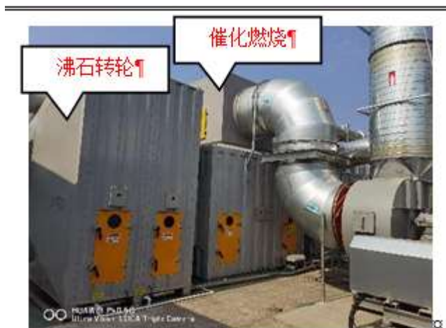
沸石吸附轉輪濃縮及催化燃燒設備
